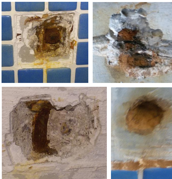
Фиг. 5. Разкрити дефектни участъци от хидроизолацията на басейна
