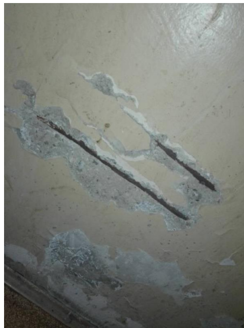
Фиг. 4. Отделяне на бетона по направление на армировката
