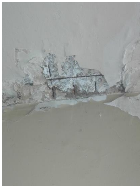
Фиг. 3. Следи от течове, корозия и разкриване на армировката
