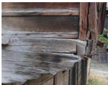
Фиг. 24. Деформация на конзолно излизащите греди и разрушение на възлите над тях
