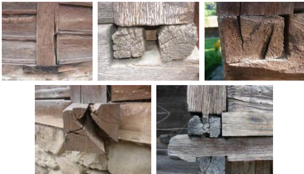
Фиг. 25. Разрушения във възли
