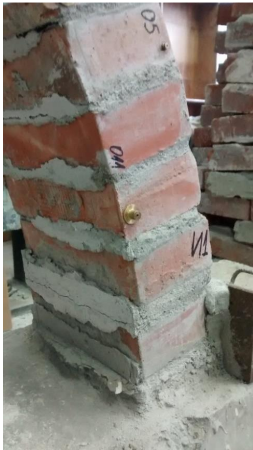
Фиг. 5. Пукнатина в опора
