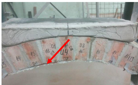
Фиг. 8. Отлепване на GRFP системата
