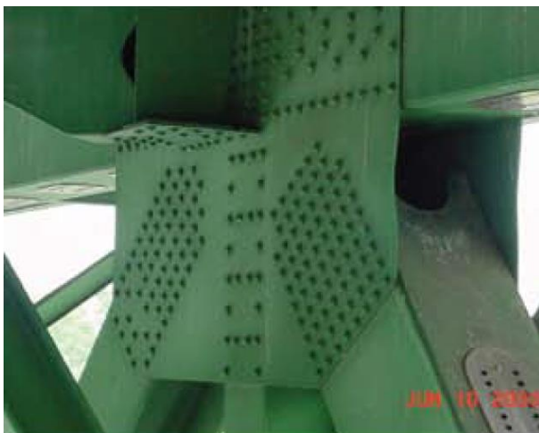
Фиг. 6. Деформирана извън равнината си възлова плоча при възел U10, 2003 г. [25]
