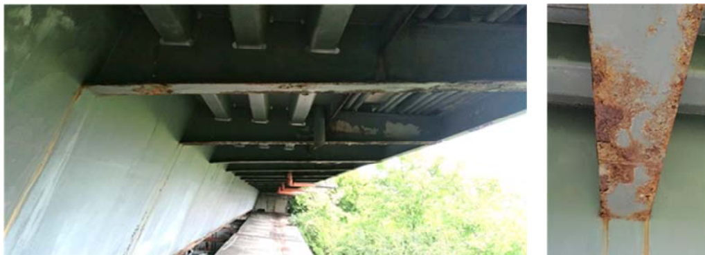
Фиг. 6. Корозия на връхната конструкция – общ вид и локална интензивна корозия
